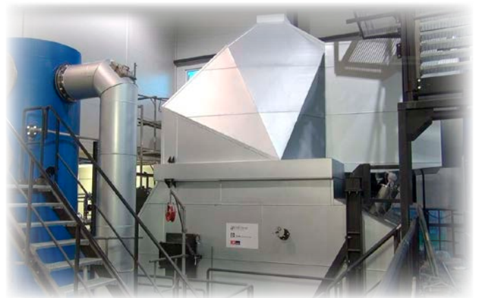
8 MW Dall Energy biomassenavn på Bogense Fjernvarme.
