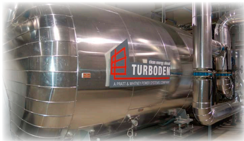
ORC kraftvarmemaskine fra Turboden.
